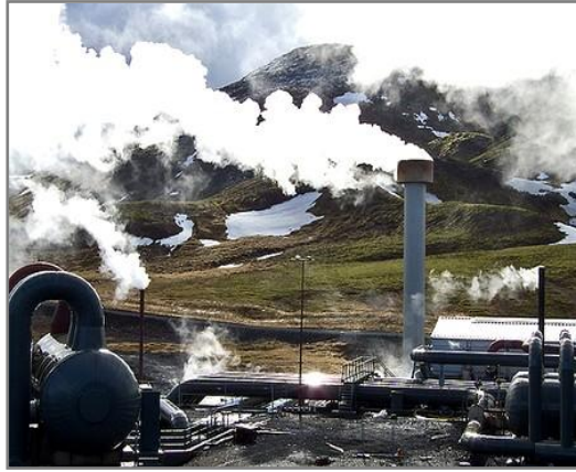
Centrale géothermique Islande CC
